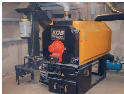
Photo 1 : Vue intérieure de la chaufferie bois
