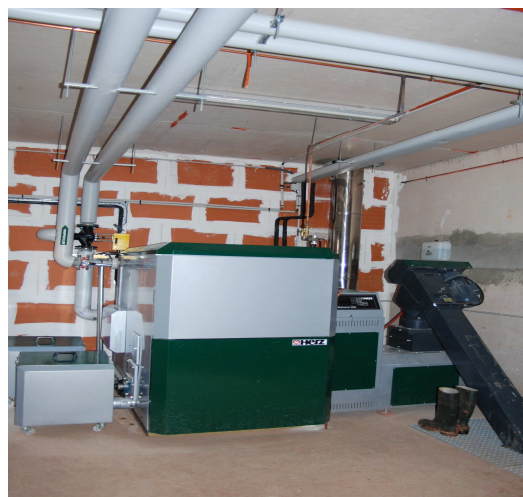
Photo 1 : Vue intérieure de la chaufferie bois
