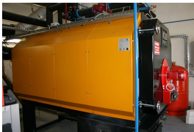
Image 2 : Chaudière bois de 300 kw
