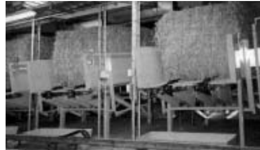
Photo : Chaudière paille balles entières
